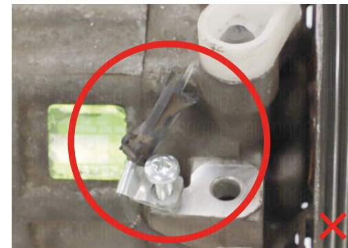
Beschädigter / fehlender Stecker
